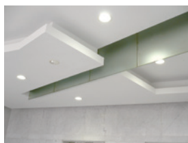
駒込データセンターのLED照明 (左、右)
