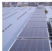
屋根のうえに設置された太陽光パネル
